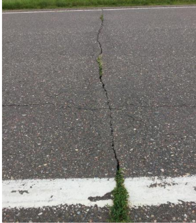
Figure 3. Thermal cracking in CSAH-8.
