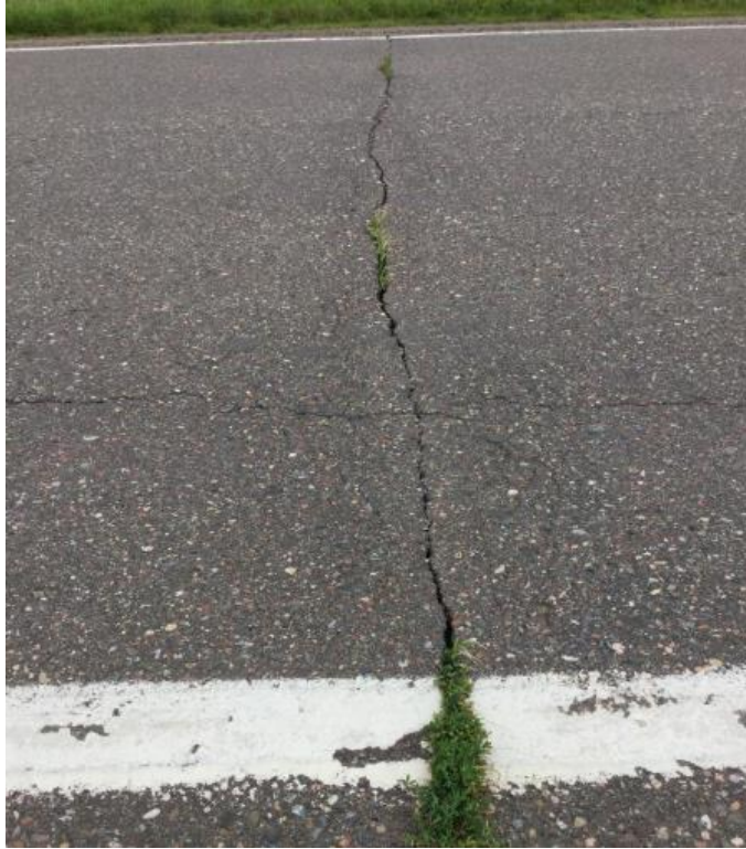
Figure 3. Thermal cracking in CSAH-8.
