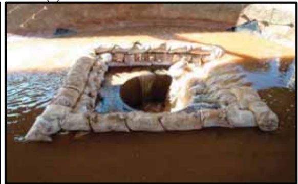
(d) square barrier failure
